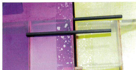
Der beiliegende Flächenverbinder ist zu kurz und musste ersetzt werden.
